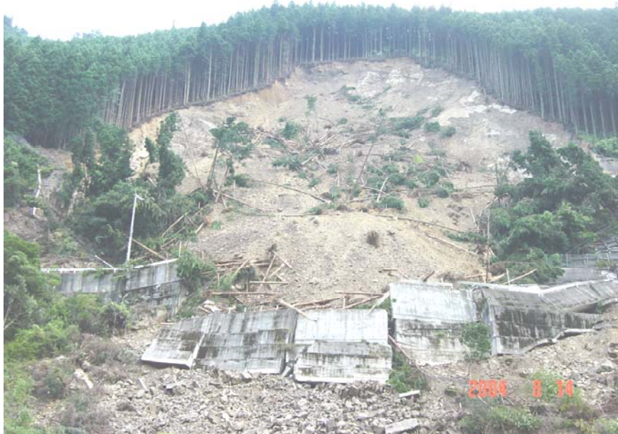
図5 崩壊地の状況
