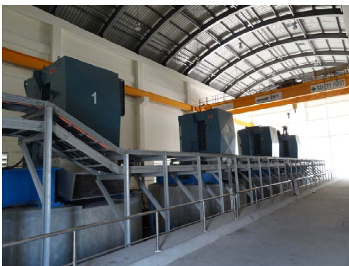
(c) 揚水用のポンプ
