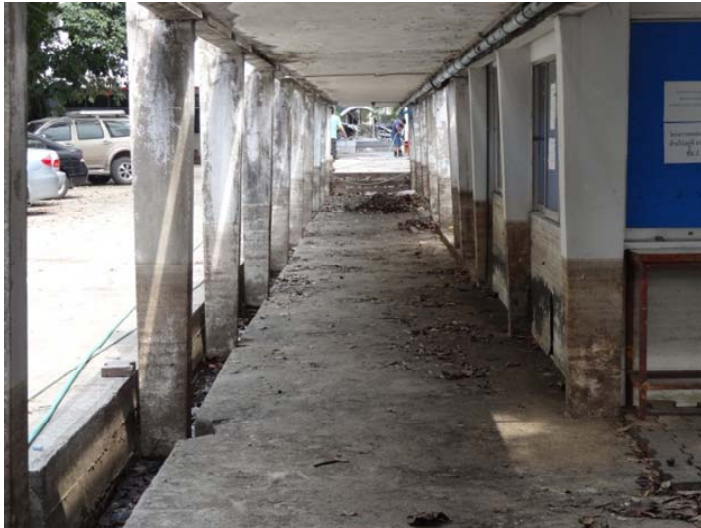
(a) 水資源工学科の建物に残された痕跡水位
