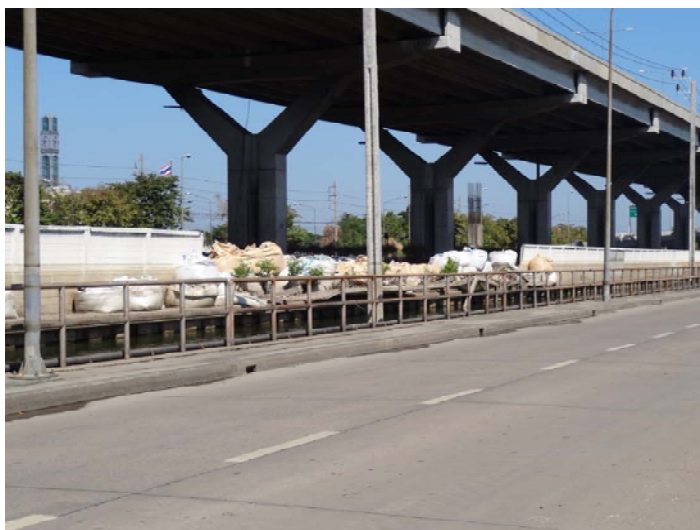
(c) 倒壊した擁壁
