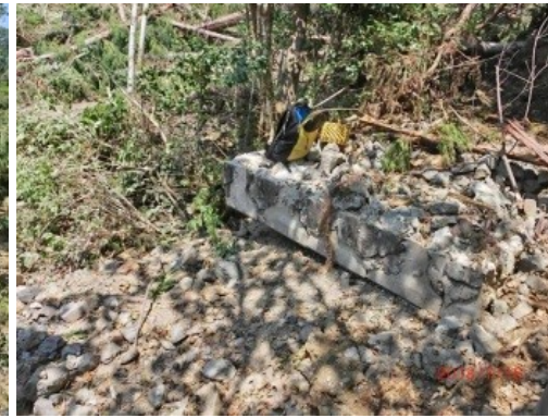
天然ダム上の道路構造物
