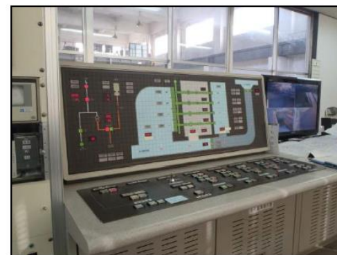
中央監視盤(3F)。2004年 更新(2Fの操作機でないと ポンプは復帰しない)
