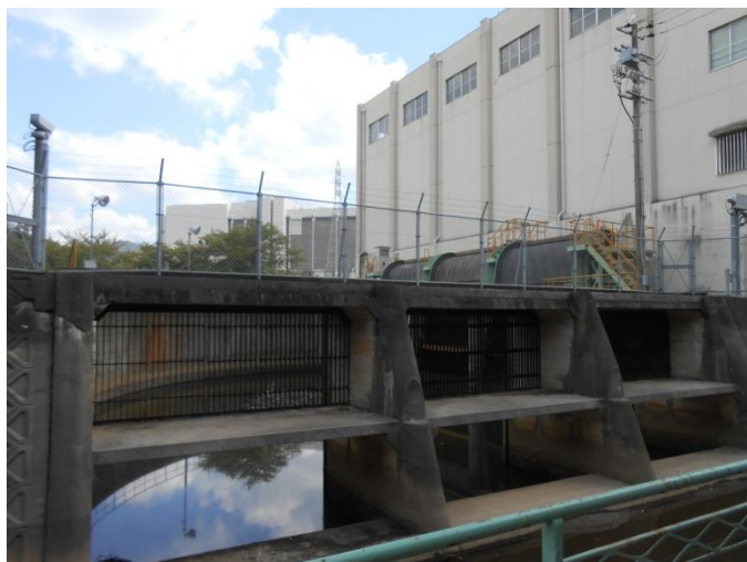
小栗栖排水機場
