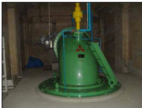
一号主ポンプ 1972年設置
