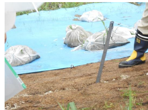
H27年5月大和川支川曾我川左岸堤防に亀裂
