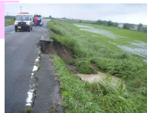
H27年8月台風15号の降雨により筑後川18.3k付近の左岸堤防表法面の崩壊(国土交通省)
