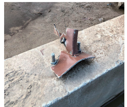
図3 破断した基礎緊結部
