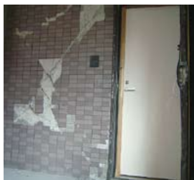
写真 (a) 福岡西方沖地震で損傷を受けた中層共同住宅
