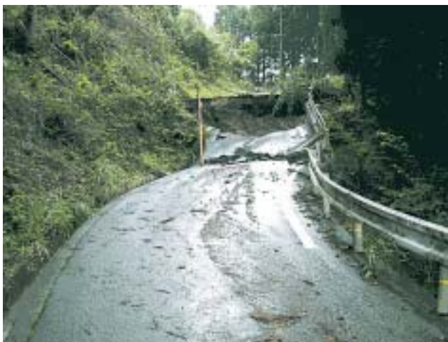
写真2 大規模な崩壊が発生した木沢村阿津江地区。崩壊地の上部には多数の亀裂が見つかっており、それら亀裂を結んだ線上に位置する林道に2m近い段差が現れた。崩壊地上部に残った不安定土塊は、少しずつ移動しているものと思われる。
