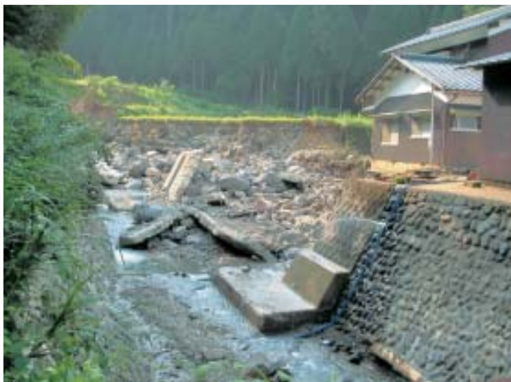
写真3 蔵作地区の側岸侵食状況（蔵作川沿い集落の上流端付近）
