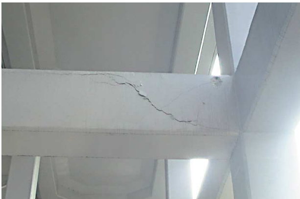
写真2 新幹線ラーメン高架橋中間梁のせん断破壊・三原市 （撮影・本田利器）
