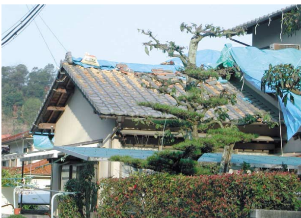
写真3 木造住宅の瓦屋根の被害（松山市）
