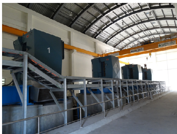
(c) 揚水用のポンプ
