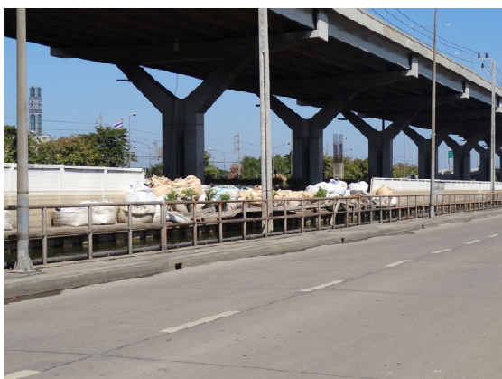
(c) 倒壊した擁壁
