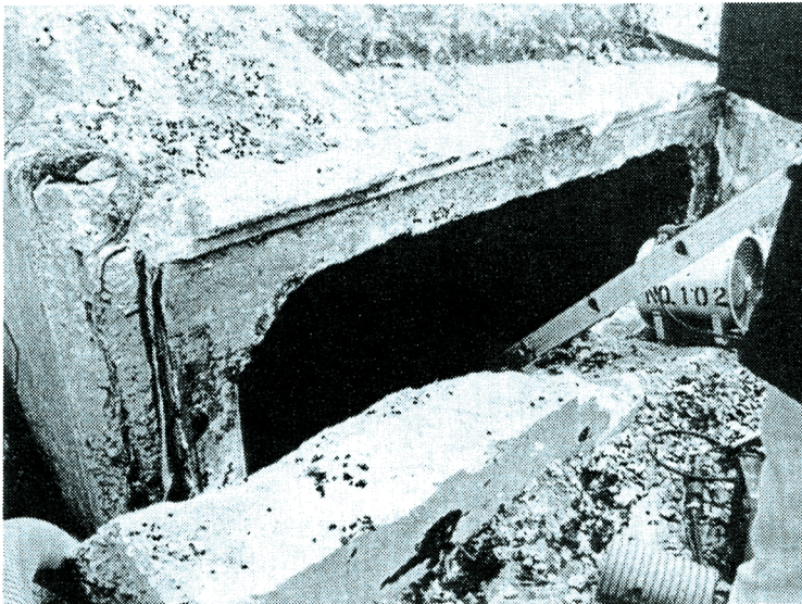
Photo 11 Dislocation of an inlet sewer conduit
