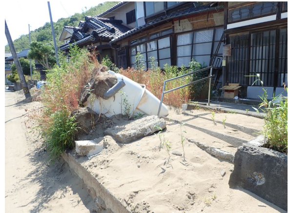
図 2 内灘町室における地中埋設物の浮上 (2024 年 6 月 11 日撮影，36°41′20.28″N， 136°40′30.74″E)
