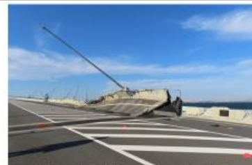
箱桁橋部分床版のめくれ上がり②
