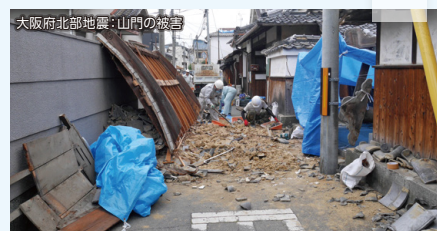
大阪府北部地震：山門の被害
