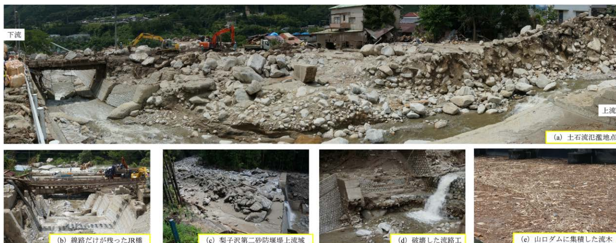
被災後の梨子沢と山口ダムの様子
