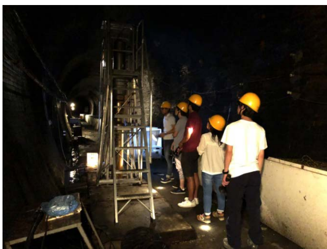
観測坑道内の地下水位観測装置
