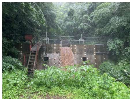
ヒル谷に設置された試験堰堤
