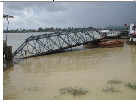
写真-1 連絡橋の被害
