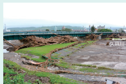
写真2 久慈川のJR八戸線橋梁に捕捉された流木。
