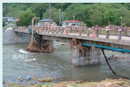
写真3 長内川の滝橋地点における流木捕捉の痕跡と氾濫被害の状況。橋の欄干の破損に加え、共架されている上水道管路の破損により断水も生じたとのこと。
