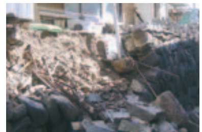
写真4 擁壁の崩壊(玄界島)
