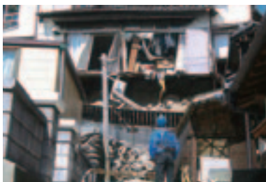
写真5 擁壁崩壊と家屋被害(玄界島)
