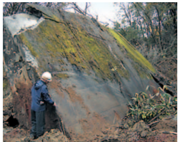
写真2 流出した重力式擁壁
