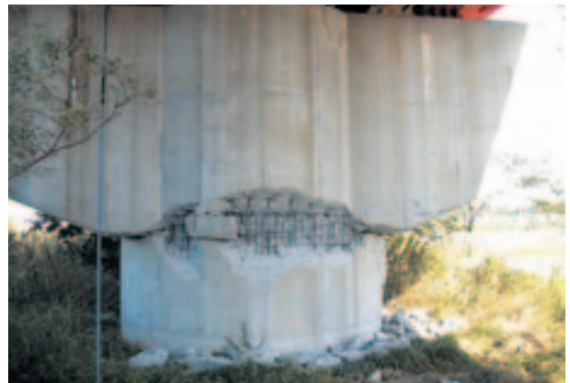
写真-4 小千谷大橋の橋脚の損傷
