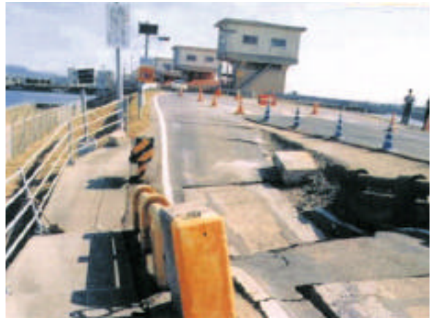
写真3 境港市 中浦水門の被害 (鳥取大池内智行・盛川仁 撮影)
