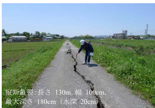
図-5 縦断亀裂 (矢形川右岸,浮島橋上流 1)
