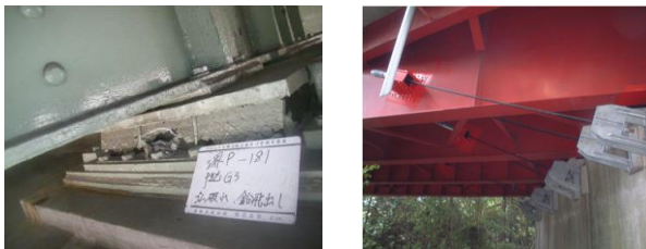
図1. 劣化ゴム支承 1) (左)とケーブルの例 2) (右)
