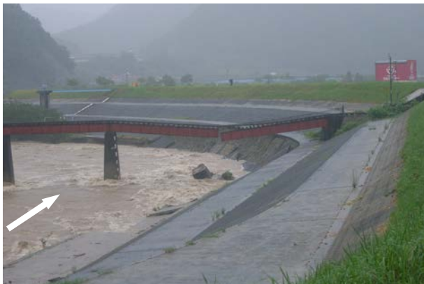
図 3 濁川における JR 橋脚の倒壊 (川本町因原)
