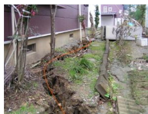
図2 中越地震における宅地盛土の被害
