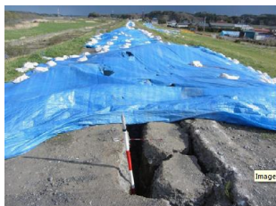
図1 東北太平洋沖地震における河川堤防の被害
