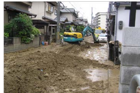
図-1 弥陀次郎川破堤地点周辺の土砂の堆積状況 (撮影: 細田)
