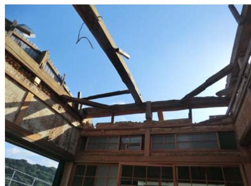
図2 田並地区で屋根が完全に破壊された 2階建て家屋
