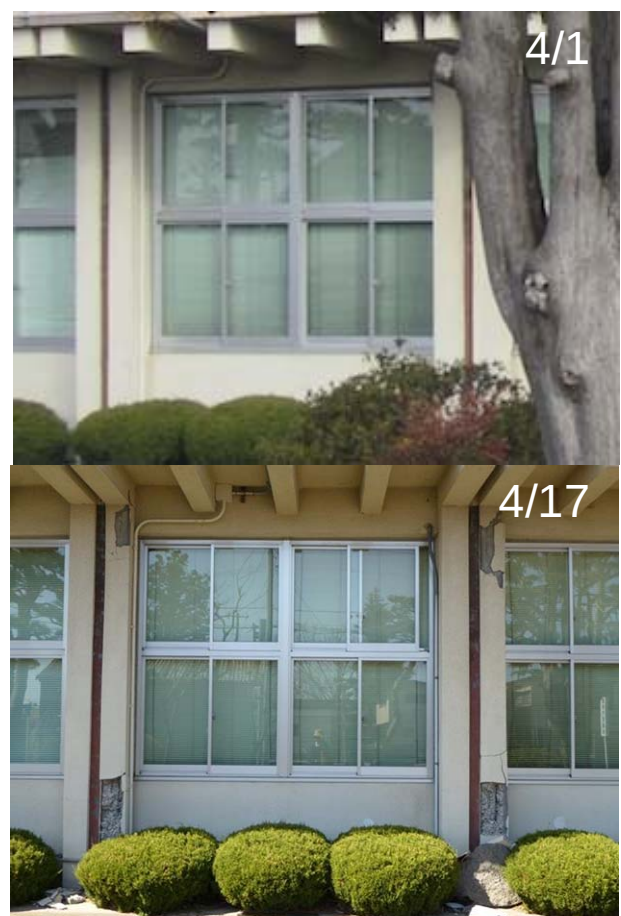
図 1：余震によって柱脚に被害を生じた栗原市役所志波姫総合支所
