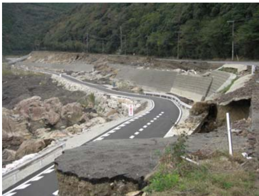
図 1 日高川における側岸侵食（日高川町高津尾）
