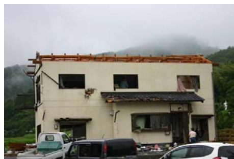
写真1 切妻屋根が飛ばされた住宅（美作市）
