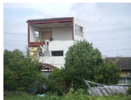
写真3 3階の外壁が脱落した住宅（土浦市）
