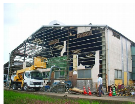
写真2 外壁等が飛ばされた工場（館林市）
